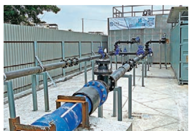
◆渠務署聯同承建商在7天內為新田社區隔離設施接駁新建公共排污系統。
