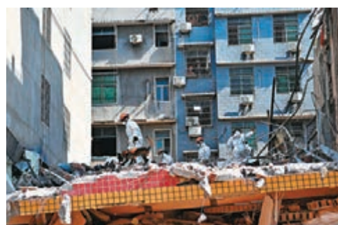
◆5月6日3時零3分，湖南長沙居民自建房倒塌事故現場搜救工作結束。事故現場被困、失聯人員已全部找到，共救出10人，遇難53人。圖為5月4日救援人員在現場救援。新華社
