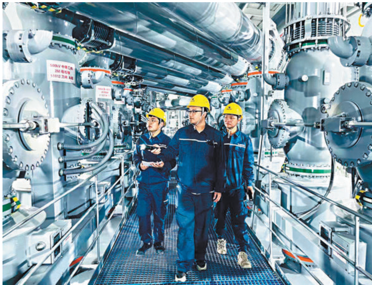
被譽為「大國重器」的粵港澳大灣區直流背靠背電網工程25日正式投產。圖為南方電網廣東廣州供電局工作人員在巡視工程開關和刀閘設備。受訪者供圖
