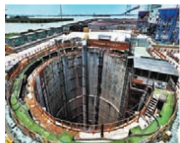
◆珠三角水資源配置工程隧洞掘進目前已完成近90%。受訪者供圖
