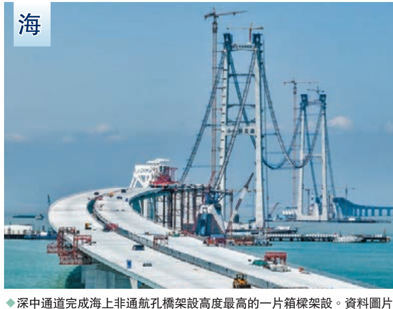
◆深中通道完成海上非通航孔橋架設高度最高的一片箱梁架設。資料圖片
