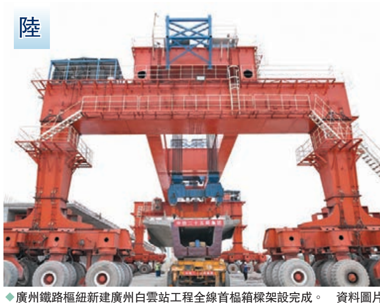
◆廣州鐵路樞紐新建廣州白雲站工程全線首箱橋架設完成。資料圖片
