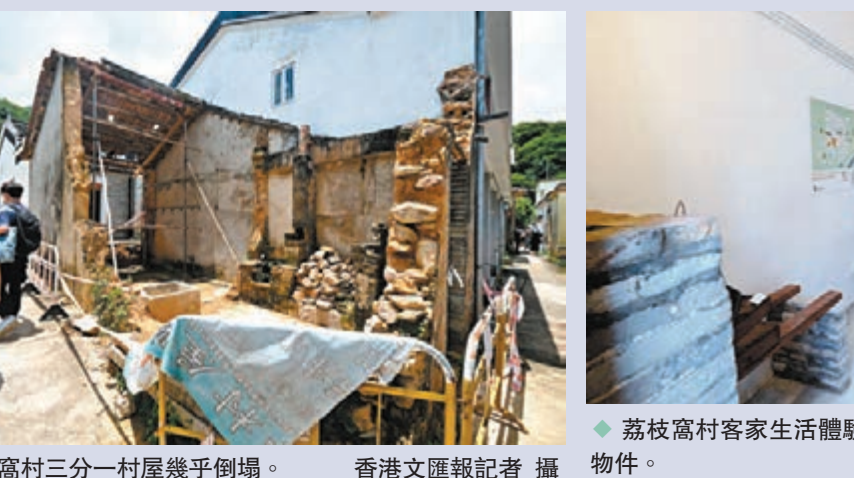
◆荔枝窩村三分之一村屋幾乎倒塌。
