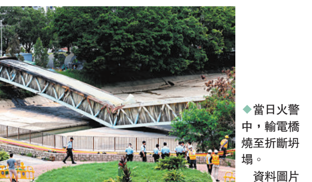
當日火警中，輸電橋樑至折斷坍塌。
