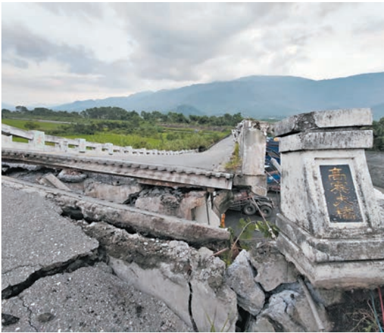
◆花蓮縣玉里鎮高寮大橋斷裂毀損。 中通社
