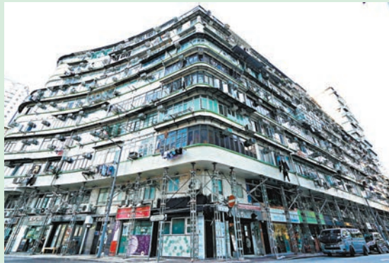
◆大角咀富貴大廈的居民每日生活在石屎天花隨時掉落危及生命的陰霾下。
