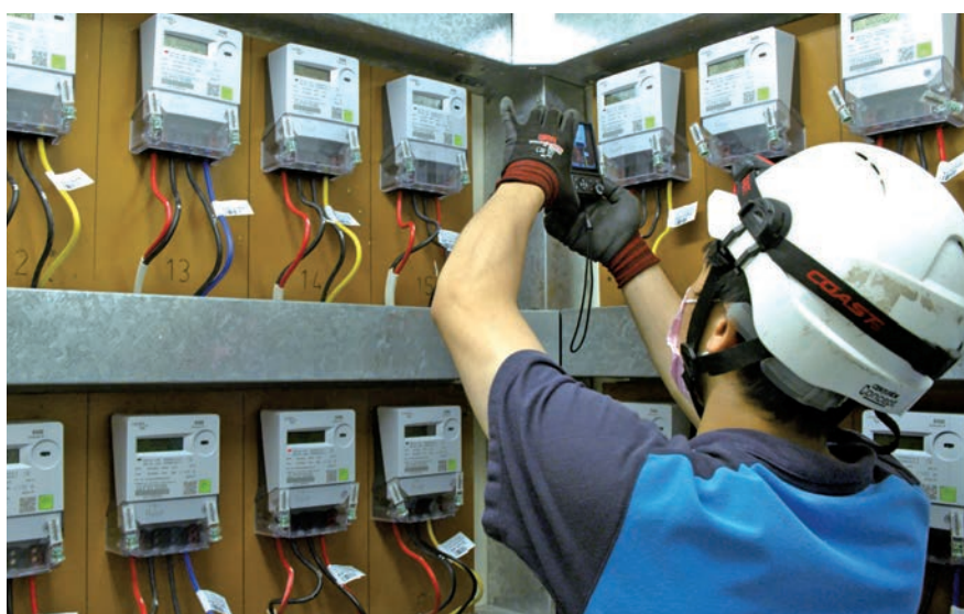
◆中電正分階段為客戶安裝及接駁智能電錶，所有安裝工作會於2025年完成。
