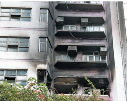
◆起火單位嚴重焚毀，樓上多個單位外牆被熏黑。 香港文匯報記者鄧偉明 攝
