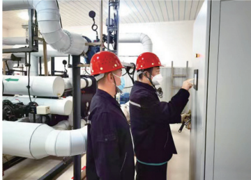
◆春城熱力工作人員及時檢查供熱設備情況。
