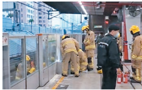
港鐵九龍灣站月台閘門故障冒煙，消防員到場撲救。
