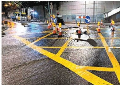
◆位於葵涌和宜合道近梨樹路交界的地底食水管昨日爆裂。
