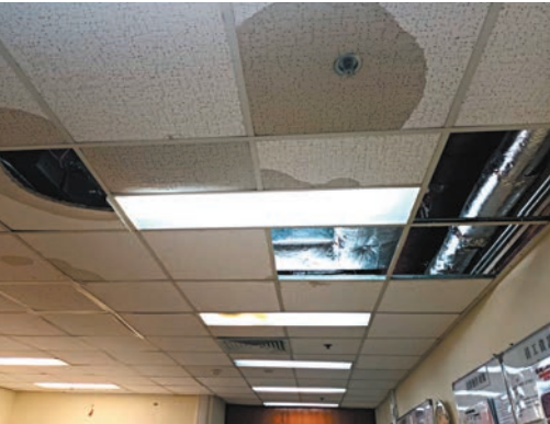
◆屯門醫院主座地庫一個辦公室內，有假天花的外層物料掉落在地上。網上圖片
