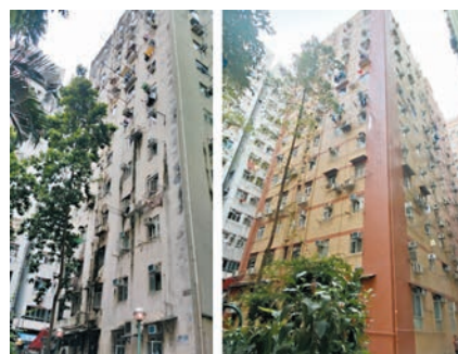
位於西環的金陵大廈最近完成樓宇復修工程。左圖：復修前。右圖：復修後。市建局網頁圖片
