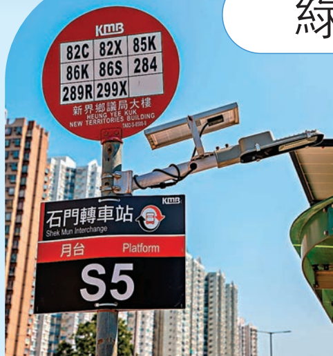
◆九巴站牌安裝太陽能板，為車站照明供電。九巴供圖
