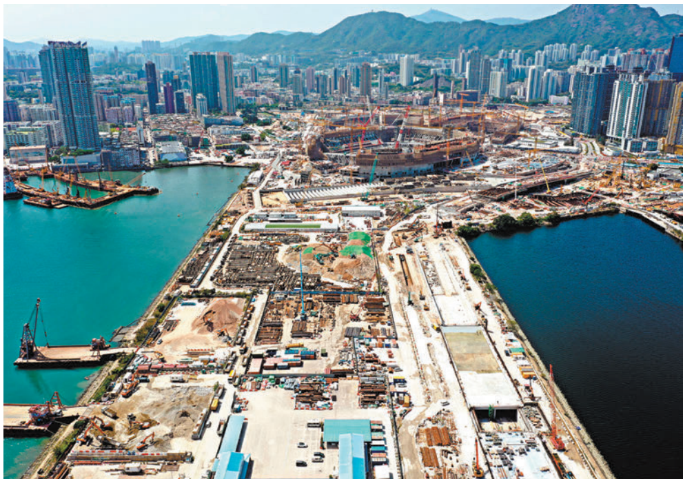
◆民建聯表示，隨着啟德體育園工程及啟德住宅項目即將完工，加上鄰近的安達臣山一帶等完成發展，他們建議引入嶄新集體運輸系統讓居民「無縫交接」往來港九不同區域。圖為啟德體育園工地。資料圖片
