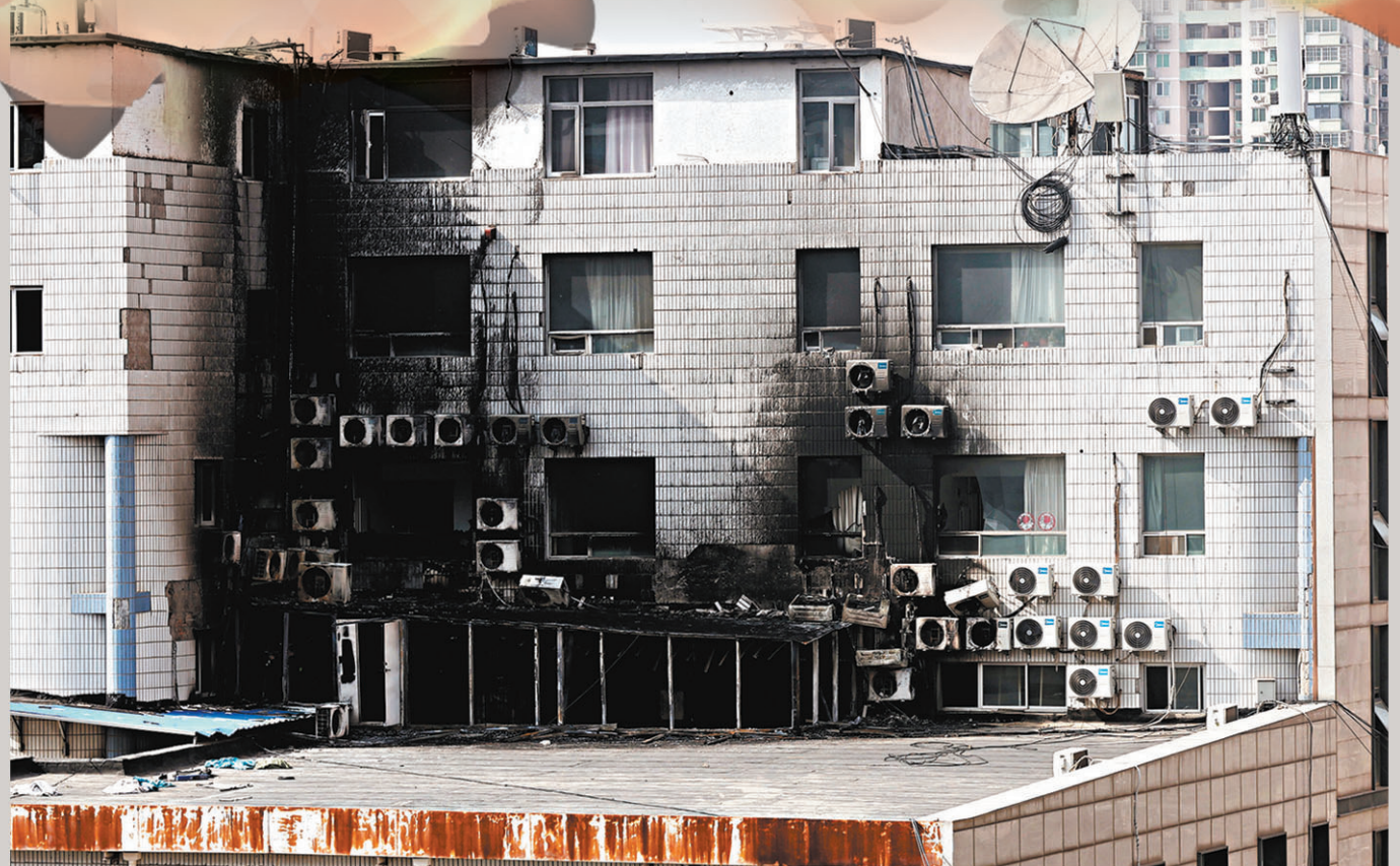
◆4月18日,北京長峰醫院住院部東樓發生火情,導致29人遇難。圖為北京長峰醫院住院部東樓燒焦的窗台和外牆。中新社
