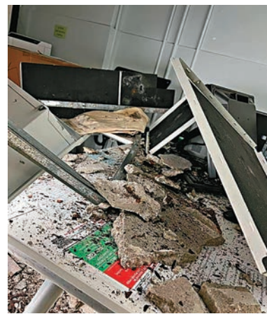
◆早前葵涌醫院踩石屎，有影印機被壓毀。資料圖片
