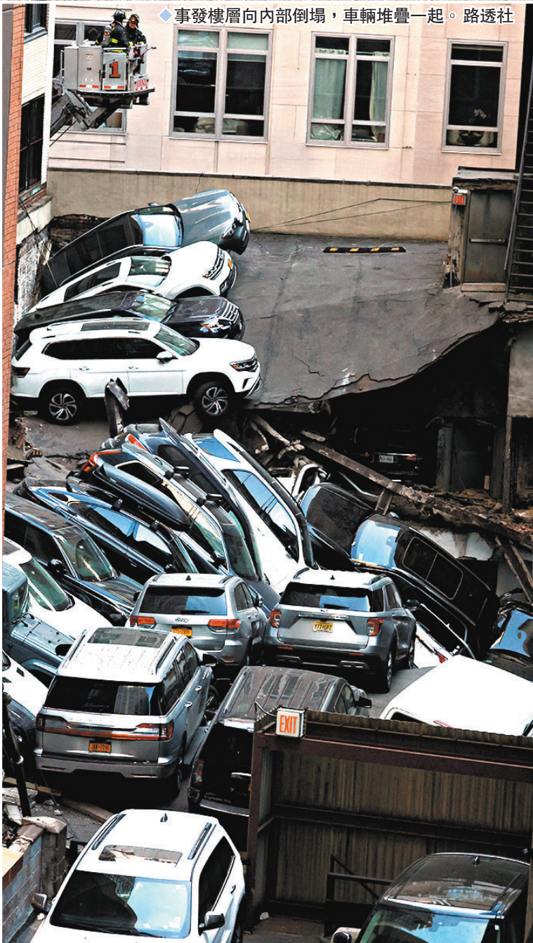
◆事發樓層向內部倒塌，車輛堆疊一起。路透社
