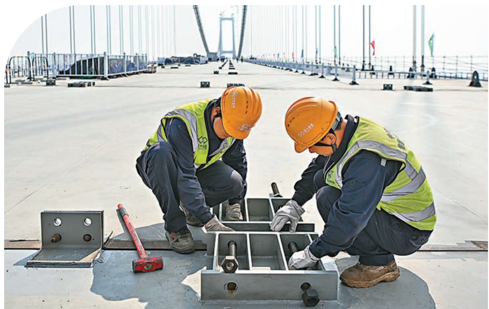
◆28日，廣東省中山市，工作人員安裝伶仃洋大橋最後一片鋼箱樑的匹配螺桿件。中新社
