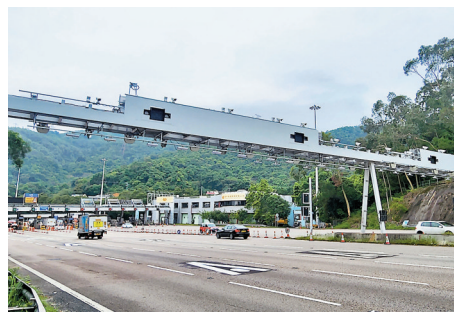
◆城門隧道將於本週日(21日)起實施「易通行」。圖為於城門隧道往荃灣方向的「易通行」收費設備(龍門架)。
