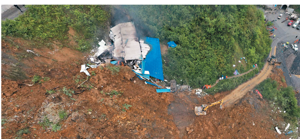
山體垮塌現場受損的工棚，不遠處救援人員正抬送一名獲救人員。
