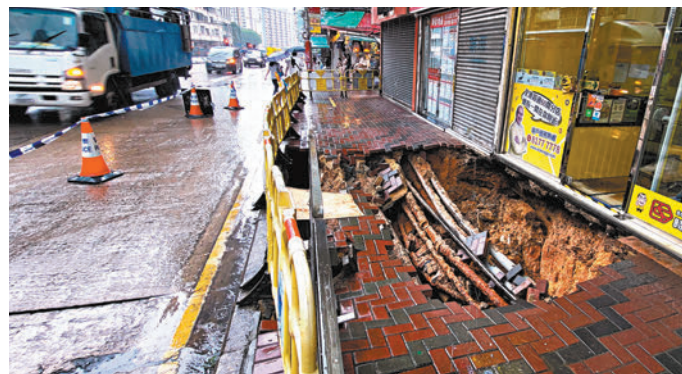
◆馬頭圍道近上鄉道行人路因爆水管導致路陷出現大坑。
