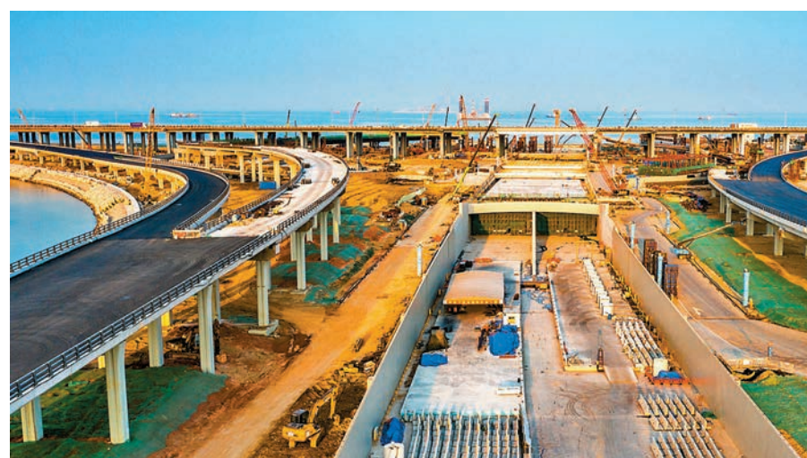
▲深中通道東人工島主線隧道施工圖。香港文匯報中山傳真
