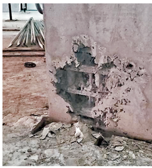
◆港大西苑重建項目出現石屎剝落，多個結構柱的混凝土出現空洞、鋼筋外露
