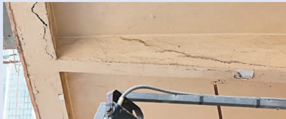
◆旺角道國際大樓騎樓底的外牆裂縫清楚可見。
