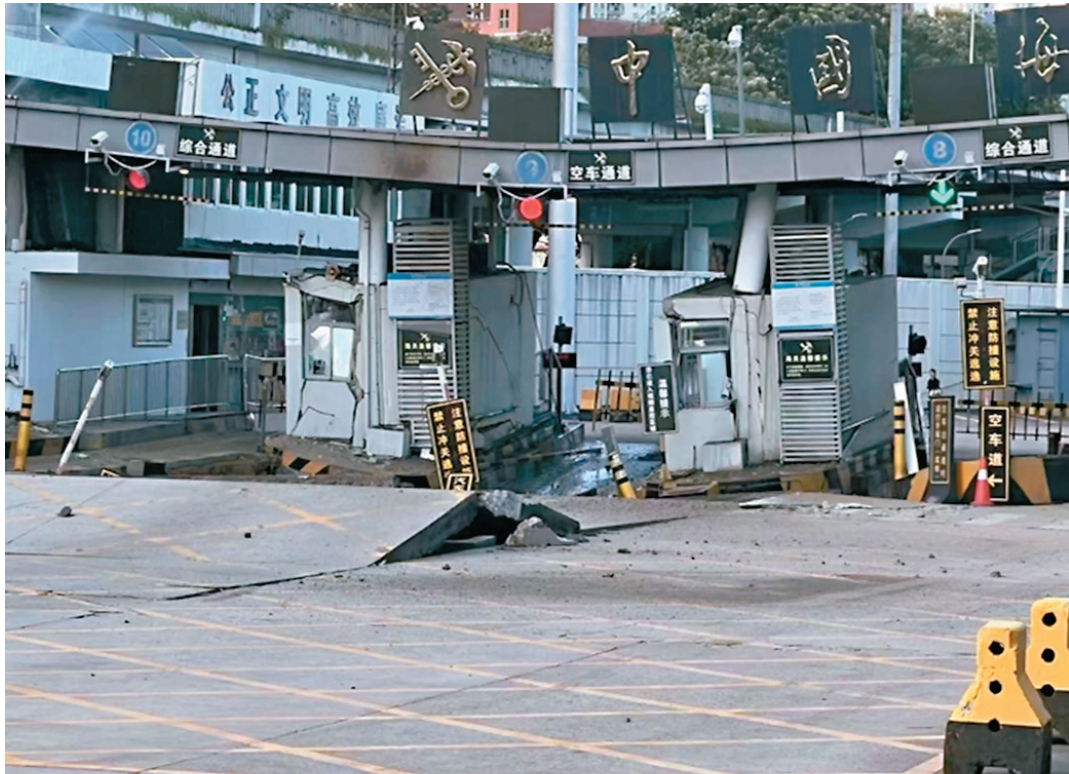
◆ 香港貨車司機拍攝的文錦渡口北行通道地面沉降，只見路面隆起，通道構築物上方則下陷。
