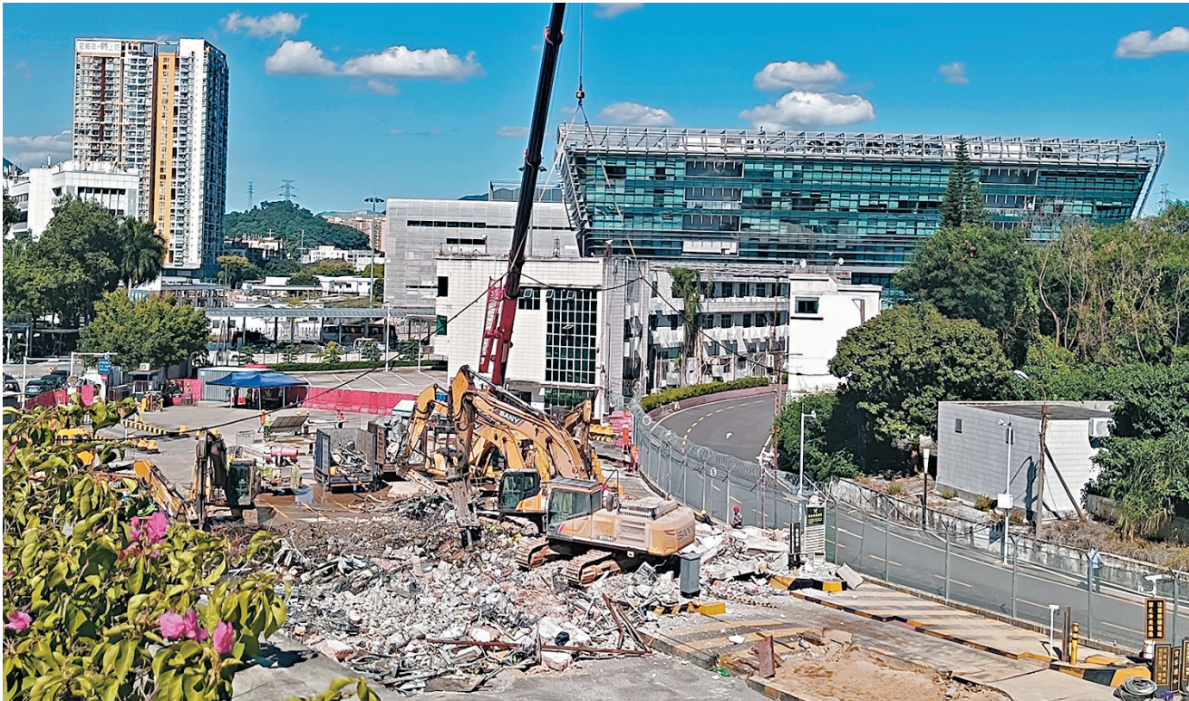
◆ 深圳文錦渡口北行通道出現地面沉降，昨日多輛工程車在搶修。
