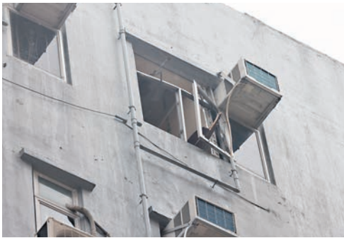
◆現場所見，電熱水爐爆炸導致單位窗戶玻璃碎裂及窗框變形。
