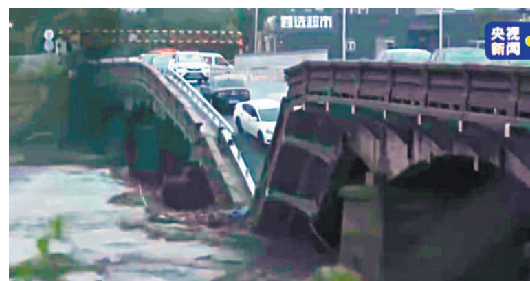
受永定河分洪影響,北京盧溝橋西側的小清河橋局部坍塌。
