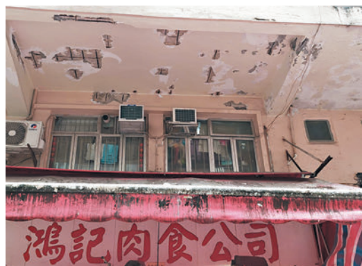
「掃雷行動」發現北角春秋街明秀大廈簷蓬出現鋼筋外露情況。
