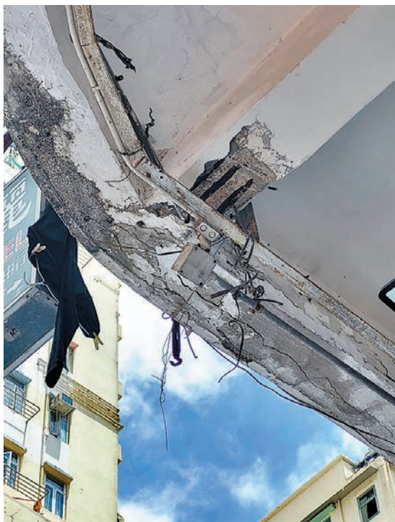
◆ 旺角通菜街37號石屎外牆有危險，消防員到場拆除。 香港文匯報記者鄧偉明攝
