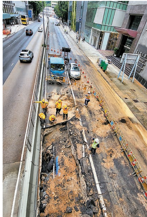
◆受爆水管影響，黃竹坑道東行線一度全封進行搶修。
