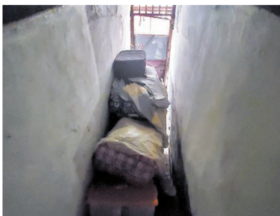
◆記者巡察發生火警的毗鄰唐樓，發現後樓梯被擺放雜物阻塞，鐵閘亦被鎖上。香港文匯報記者 劉友光攝
