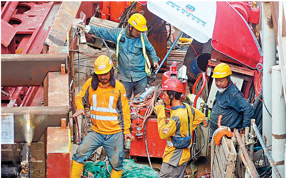
◆香港建造商會昨日宣布推出《工作暑熱警告下建造業實務指引》，強調並非取代勞工處指引。圖為地盤工友在暑熱下休息。
