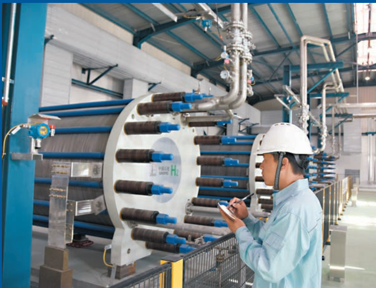
網上圖片 ◆中國石化新疆庫車綠氫示範項目的員工對製氫設備進行巡檢。資料圖片
