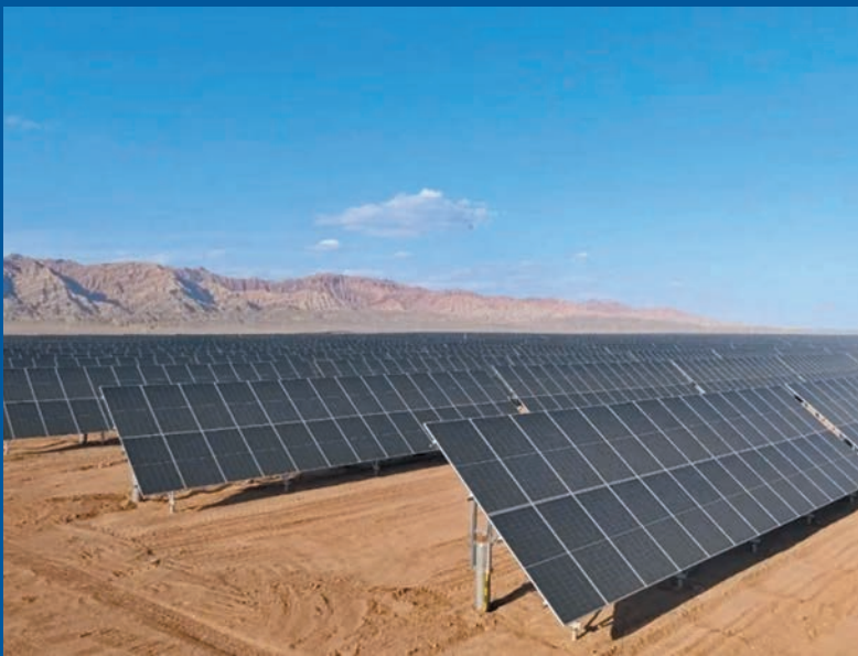
◆中國石化新疆庫車綠氫示範項目光伏廠內光伏板。
