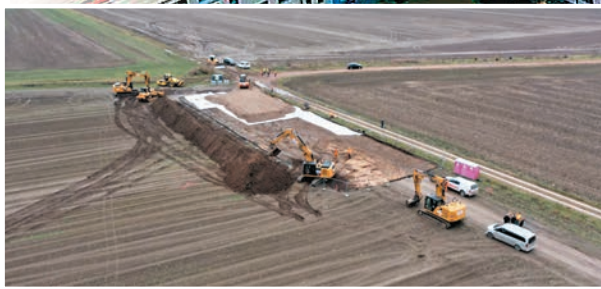
◆英特爾望從明年起在馬德堡建廠。圖為當地工人進行初步挖掘工程。網上圖片
