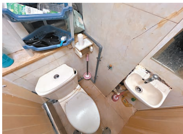
◆十多人共用一個狹小破舊的洗手間。
