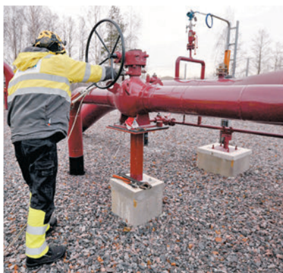
◆管道因洩漏出現壓力異常下降，被迫關閉閥門。資料圖片
