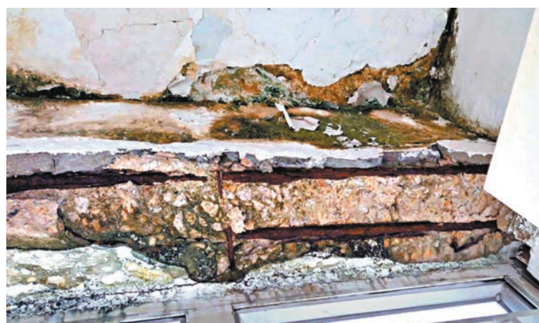
◆「十三街」有樓宇出現石屎剝落，鋼筋外露。黃國Fb圖片
