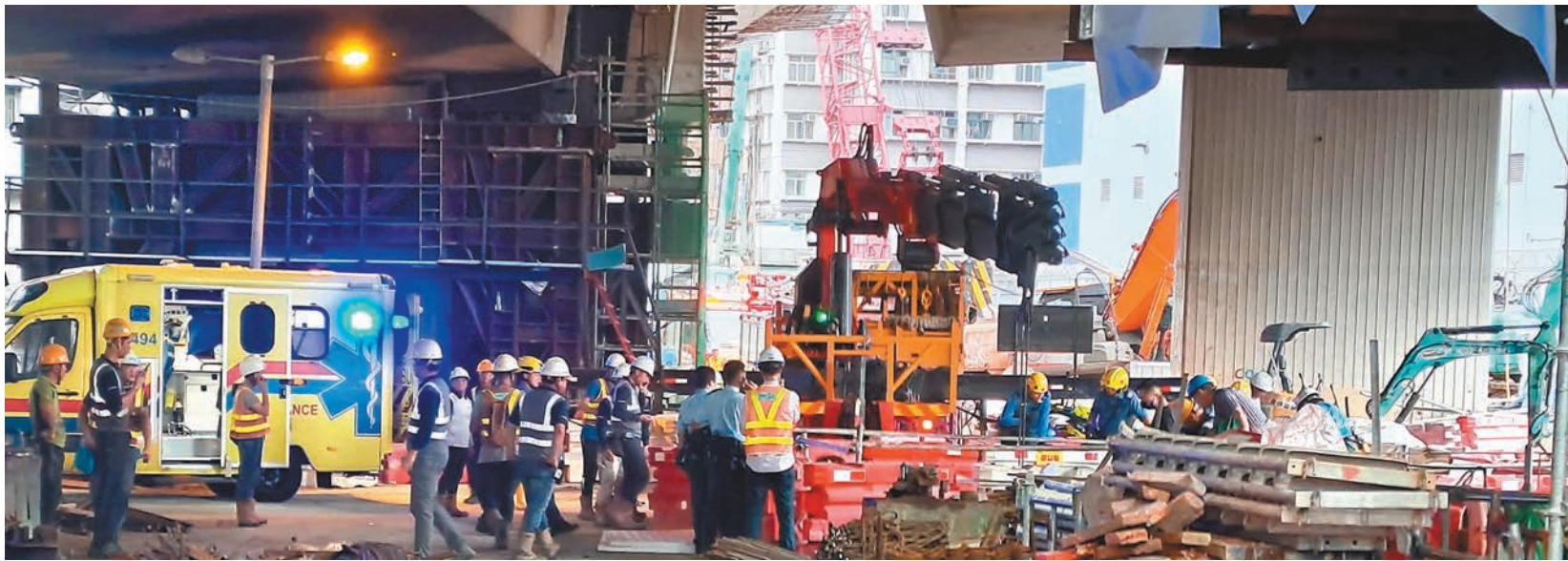
油麻地中九龍幹線地盤昨日發生吊運中鋼筋墜下地底壓困工人意外，消防員到場拯救被困傷者。
