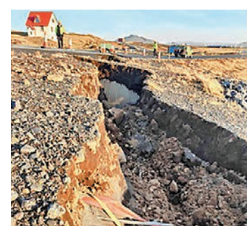
格林達維克鎮周圍多處地表開裂。
