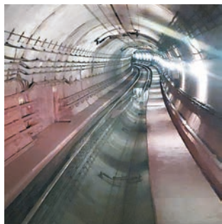
◆港鐵鯪魚涌站附近一段隧道內出現的積水淹浸一段路軌。 議員張欣宇供圖
