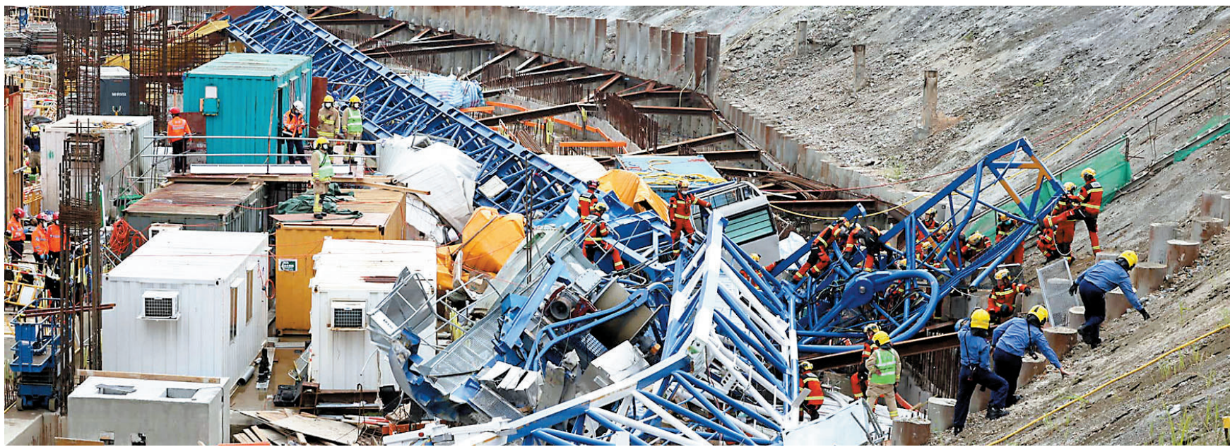
◆香港近年接連發生地盤意外，令社會關注建造業施工安全問題，業界正推動建立一個地盤安全記分制。圖為去年9月安達臣道塌天釀3死6傷意外。資料圖片
