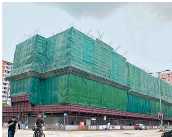
◆ 市建局盛德街項目地盤正進行清拆工程，重建後可提供約640個住宅單位。
