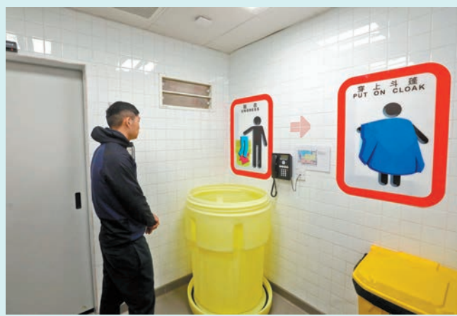
◀◀ 消防處在機場禁區內新增一座固定洗消設施。一旦在禁區內或航機上發生化學、輻射等事故，消防人員可迅速地為大量受污染人士進行洗消，以保障公眾人士的安全。香港文匯報記者郭木又 攝
