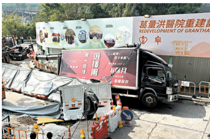
◆吊臂車翻側後連壓兩車，吊臂壓中密斗車頂，車身壓中客貨車。
