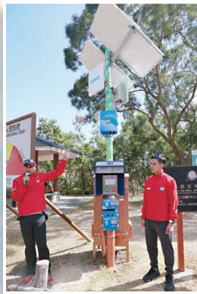
◆「緊急站」除可供求助救援,並設有太陽能板為裝置儲電及供市民充電。
