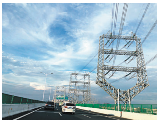
◆去年廣東工業中的製造業用電量佔比近五成，新能源產業成為亮點。圖為在廣東高速公路附近的電網。 香港文匯報記者方俊明 攝
